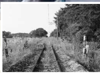
草が覆いかぶさり錆びついた JR線路
